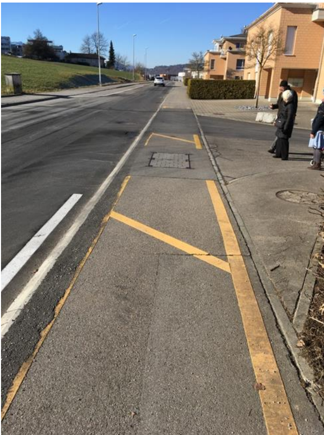
Bild links: Fehlende Trottoir-Markierung Hartenfelsrain/Hartenfelsstrasse
